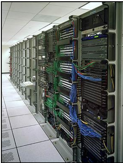
Resim 4: Bir data center genel görünümü
